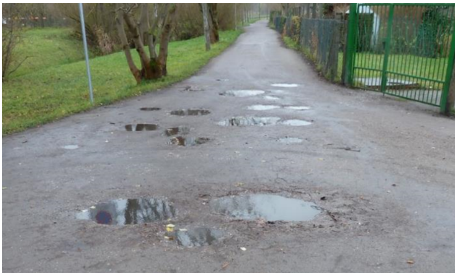
Abbildung 1: wiederkehrende Oberflächenschäden infolge Nutzung und mangelhafter Entwässerung, Anfang Abschnitt A
